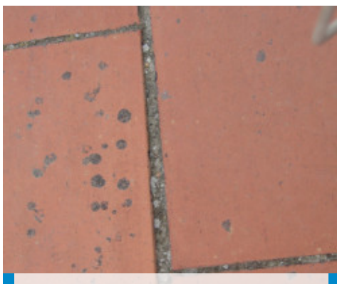
Bestaande cottovloer die moet worden voorbereid alvorens Aquaflex Roof aan te brengen
